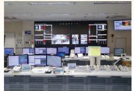
(令和4年現在) ▲ 機器の更新がなされた現行の消防指令センター
